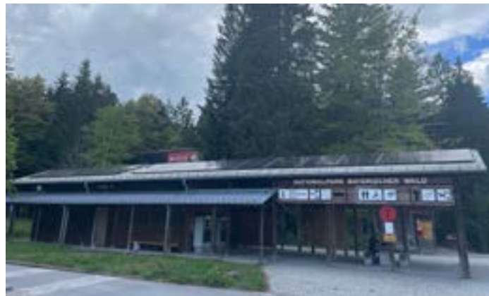
Auf dem Dach des Servicegebäudes am P1 des Nationalparkzentrums Lusen wurde eine von vier neuen Photovoltaikanlagen installiert.
