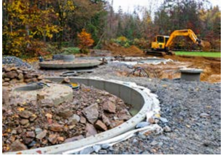
Der Bau des Kreuzotter-Geheges im Tier-Freigelände hat bereits begonnen. Foto: Gregor Wolf
