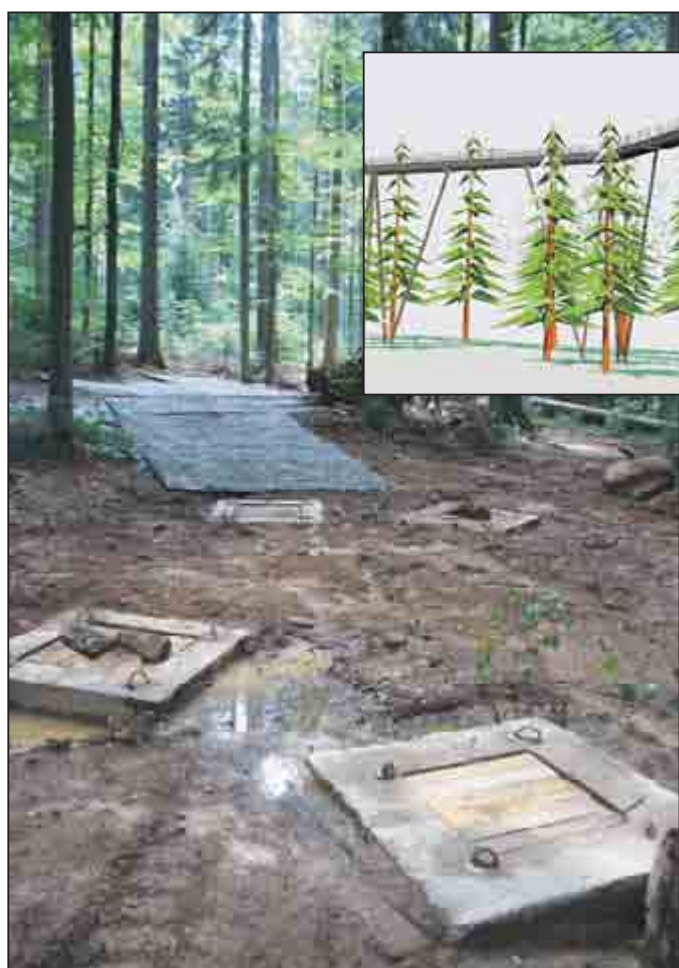
Die Fundamente für die Holzstelzen des Baumkronenpfades sind bereits betoniert. „Matrassen“ für den naturschonenden Bau sind ausgelegt.
