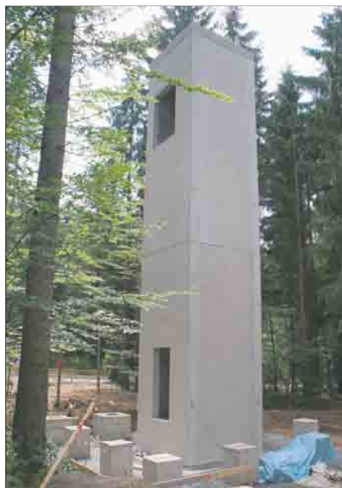
Der Schacht für den Lift ist schon betoniert. Er ermöglicht später einen barrierefreien Zugang zum Baumwipfelpfad.
