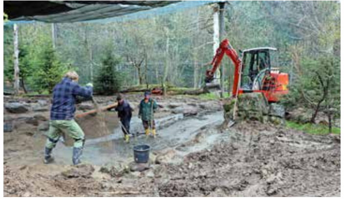
Der Teich in der Großvoliere „Vögel am Waldrand“ war undicht, so dass er ein Betonfundament bekommen hat. Foto: Gregor Wolf
